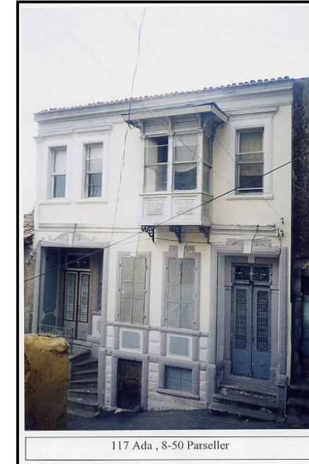
Fotoğraf 4.6 Onarım Gerektirmeyen İki Yapı- 117 ada, 8-50 parseller
