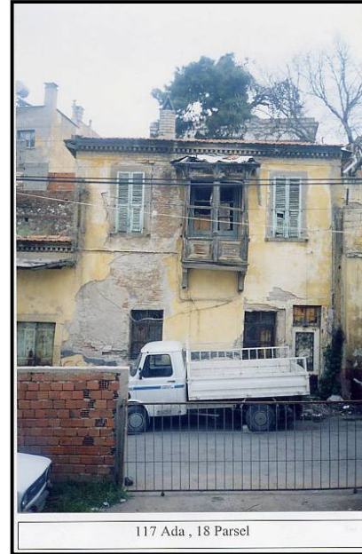
Fotoğraf 4.2 Konut Dokusu İçinde Onarım Gerektiren Yapı - 117 ada, 18 parsel
