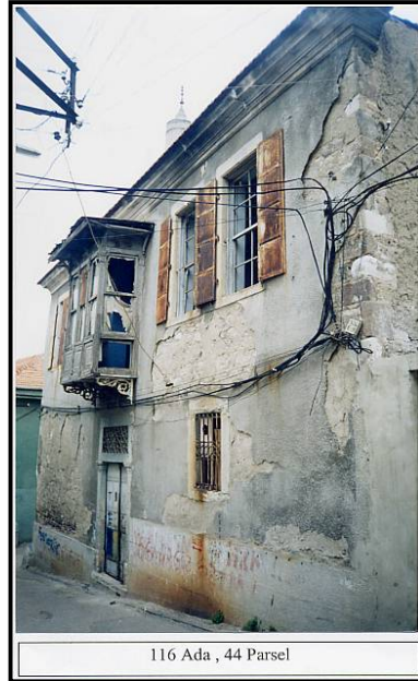
Fotoğraf 4.1. Konut Dokusu İçinde Onarım Gerektiren Yapı - 116 ada, 44 parsel
